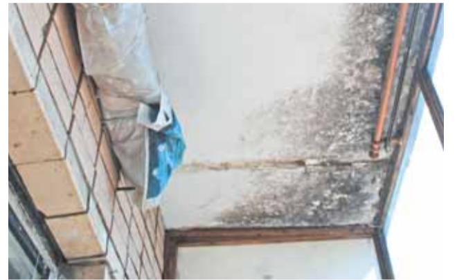
Отсыревший потолок балкона в одной из квартир дома 38 по ул. Красная Пресня
